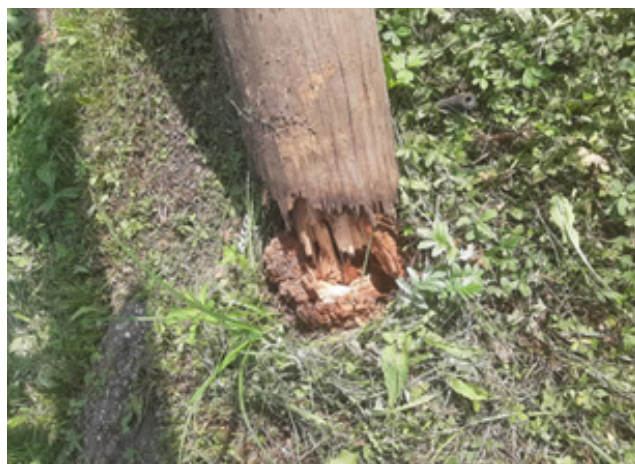
Рисунок 1 – Вид состояния структуры древесины у основания столба после обрушения опоры
