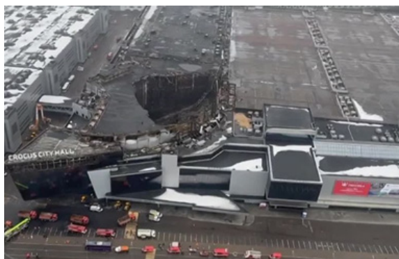
Рисунок 1 – Иллюстрация разрушений КЗ Крокус Сити Холл в результате террористического акта 22.03.2024 г.
