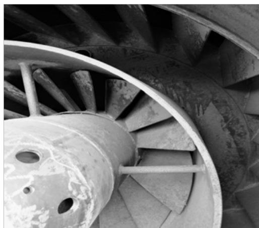
Рисунок 1 – Эксплуатируемое горелочное устройство типа ГМУ-45 котлоагрегата типа ТГМЕ-464
