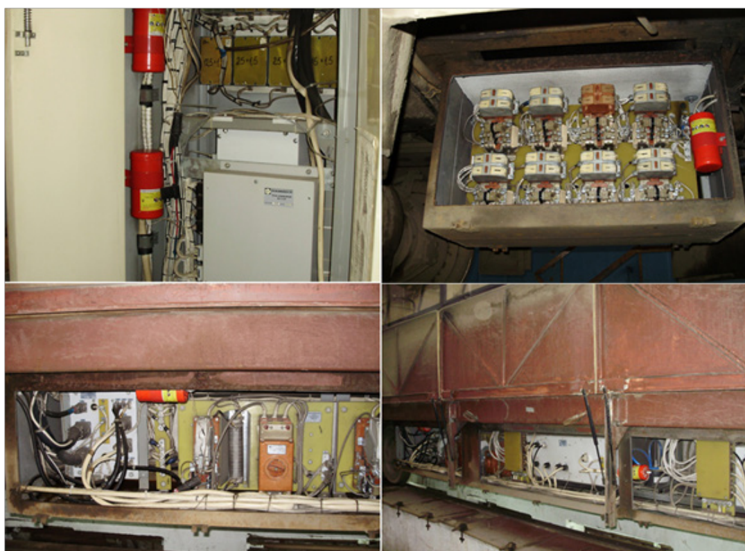
Рисунок 7 – Размещение модулей пожаротушения в распределительных шкафах и отсеках
