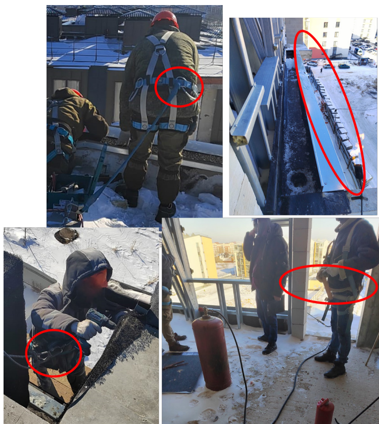
Рисунок 2 – Результаты фотофиксации выявленных нарушений в процессе выполнения работ
