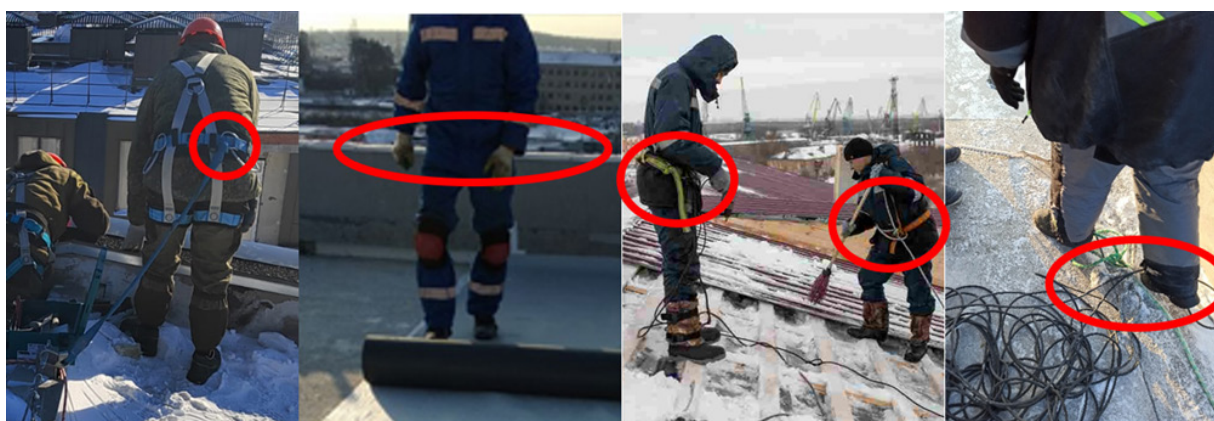
Рисунок 2 – Зафиксированные опасные действия работников с высоким риском падения с высоты в рамках выездов на строительные площадки г. Санкт-Петербурга
